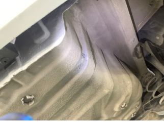
Arka bölüm, Bagaj havuzu > Hasarlı
