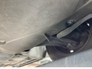
Motor, Alt muhafaza > Hasarlı
