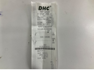
Elektrik donanımı/Pano, Akü > Test Sonucu
