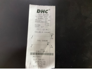
Elektrik donanımı/Pano, Akü > Test Sonucu
